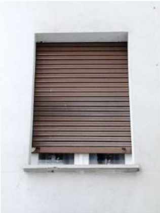
3. Oscuranti in pvc sul fronte Ovest
