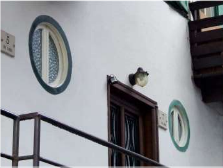
6. Fori circolari sul fronte Sud
