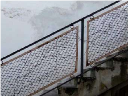
5. Parapetto in metallo della scala esterna
