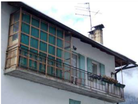
12. Balcone in c.a. con superfetazione sul fronte Est
