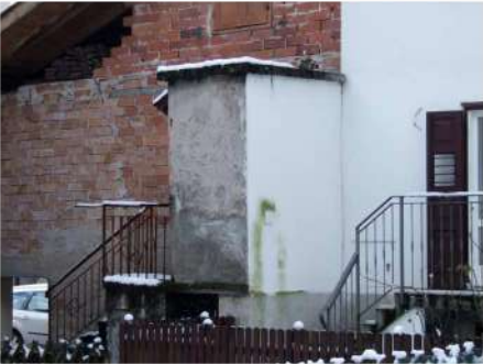
12. Superfettazione sul fronte Est
