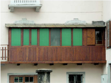
14. Superfetazione lignea sul fronte Nord
