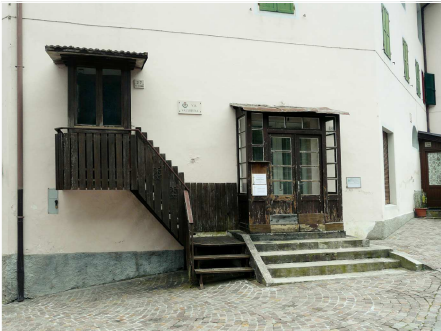
17. Superfetazioni lignee sul fronte Ovest
