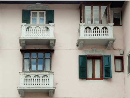
16. Superfetazioni lignee sul fronte Nord
