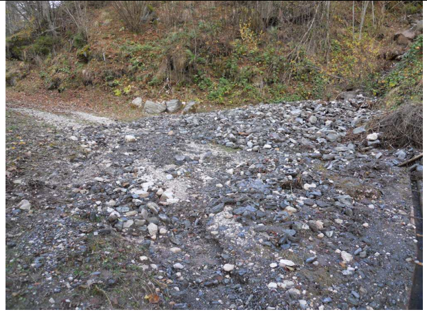
Le erosioni che hanno coinvolto la strada sono state causate dal deflusso del collettore che, intasata la tubatura dell'attraversamento, ha percorso la massicciata.
